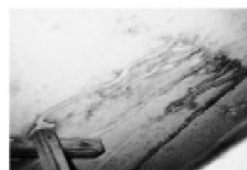
屋上からの漏水による汚れた状況の確認
