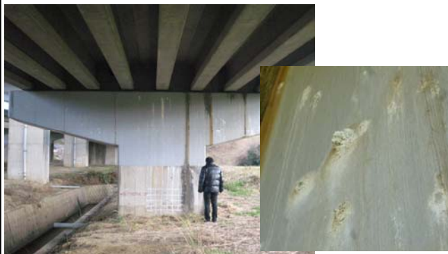
橋脚のASR再劣化事例(塗膜を剥がしてみると・・・)
