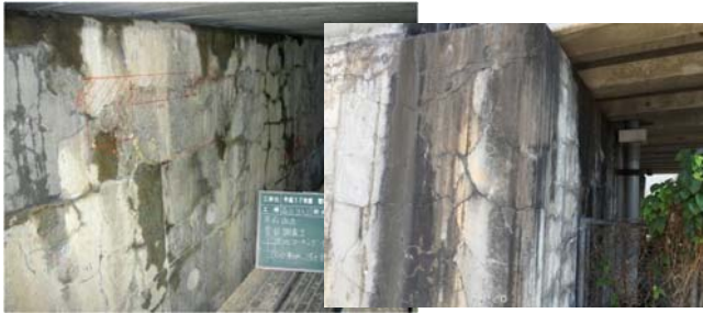
橋台のASR劣化事例
