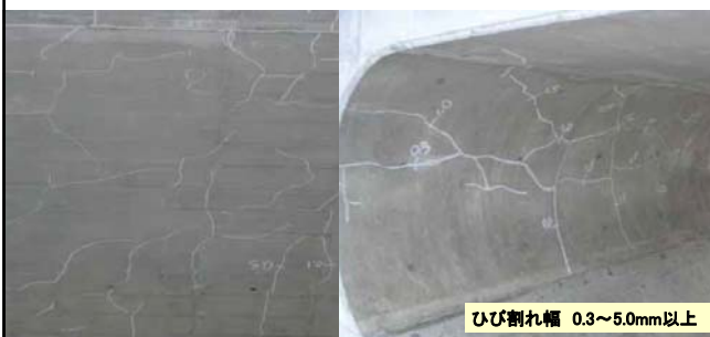
二郷橋(秋田県)のASR劣化事例
