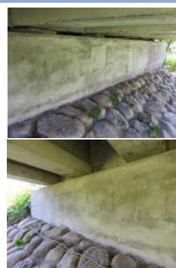
米岡小橋(鳥取県) H22度施工(ASR) H27年5月撮影
