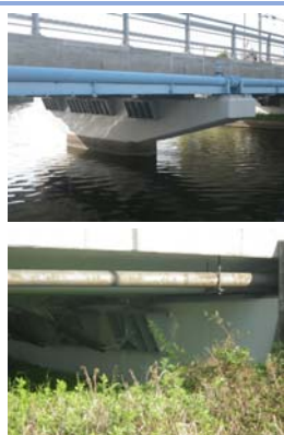
大橋(香川県) H24度施工(ASR) H28年4月撮影
