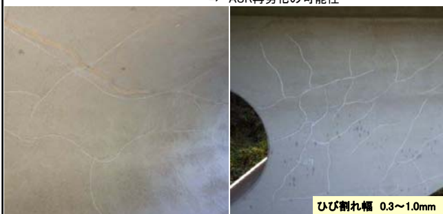
二郷橋(秋田県)のASR劣化事例
