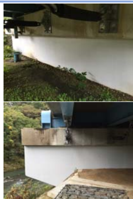
仁多大橋(島根県) H26度施工(ASR) H27年10月撮影
