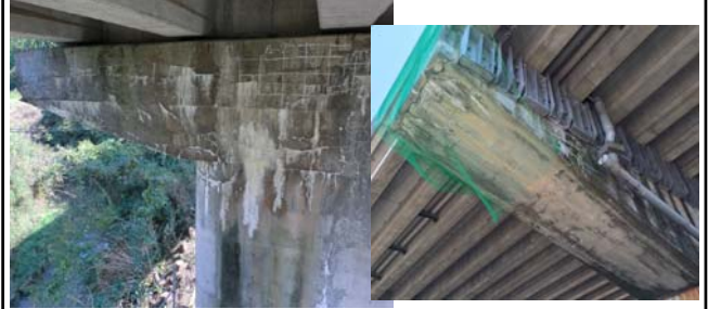
橋台のASR劣化事例
