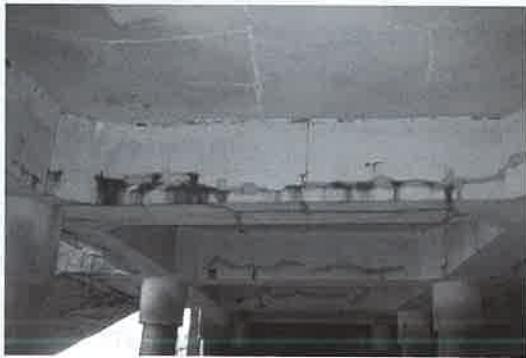
図2 塩害によるコンクリート構造物の劣化事例
