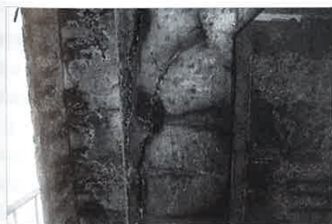
写真1 塩害によるひび割れの事例
