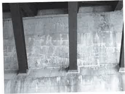
写真2 ASRによるひび割れの事例
