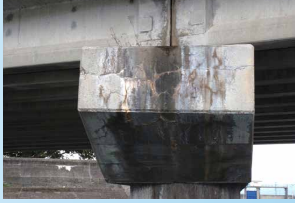
ASRで劣化したコンクリート
