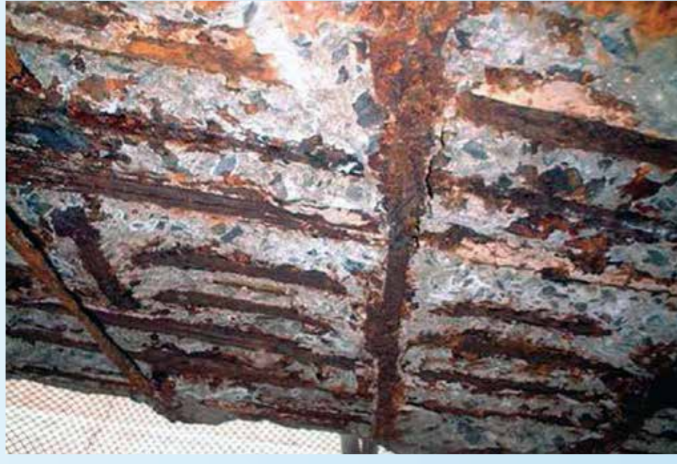
塩害で劣化したコンクリート
