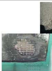
(床版下面) 床版の抜け落ち
