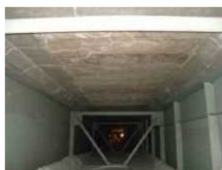
ひび割れの発生
