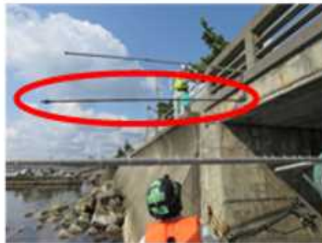
▲PC鋼材の突出事例
