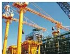
スケータークレーン
