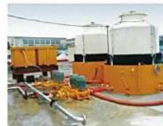
冷却設備 (クーリングタワー)
