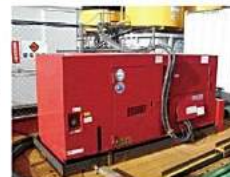
非常用発電機
