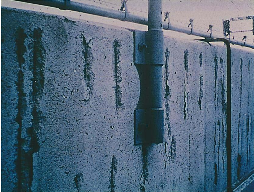
壁高欄のコンクリートはく落
