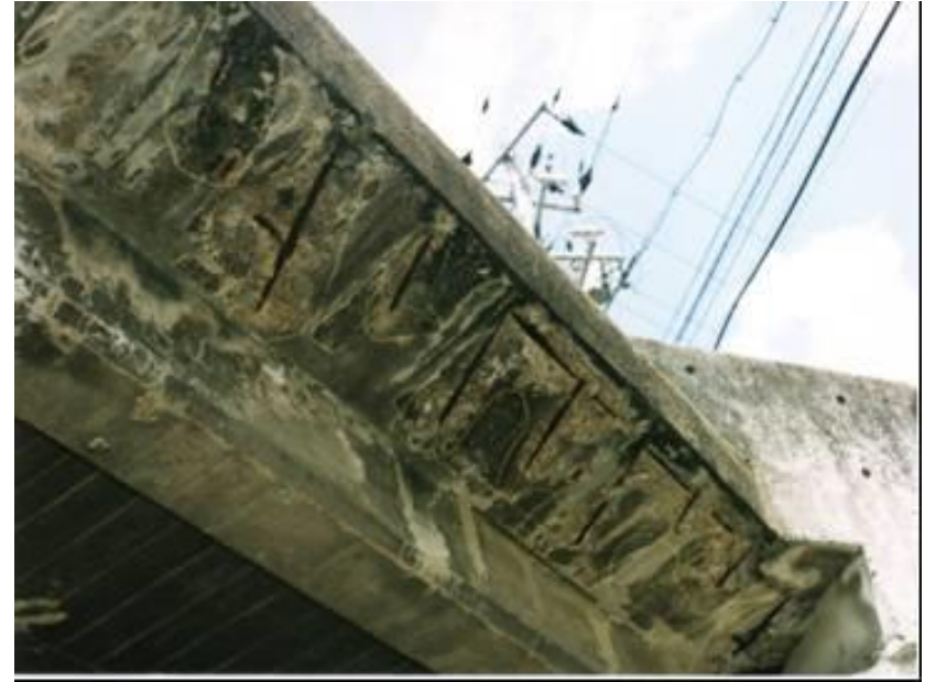
張出し床版下面の鉄筋露出
