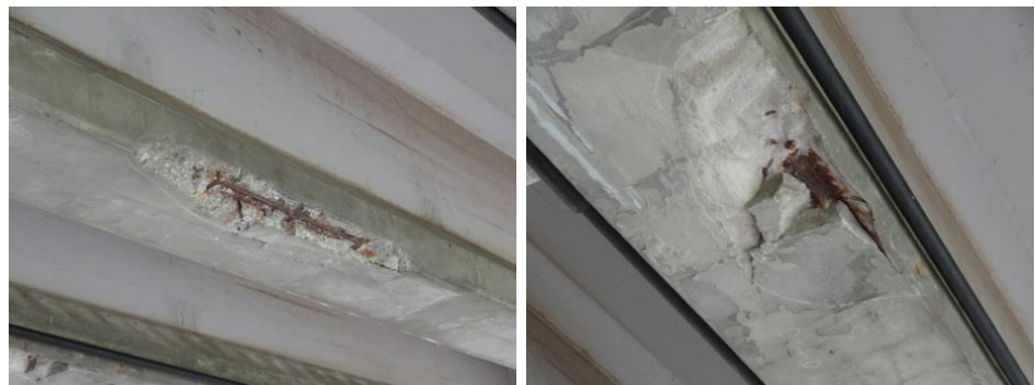
下フランジ底面の剥離
