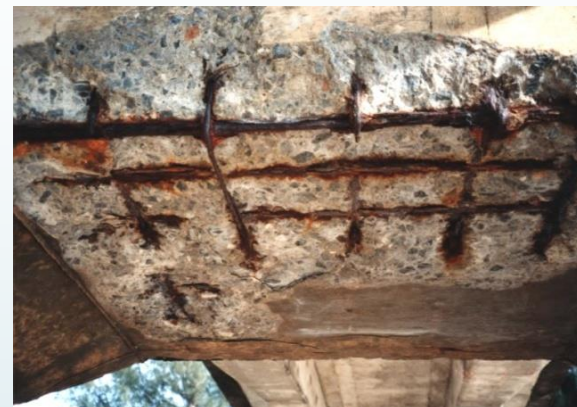
塩害による劣化
