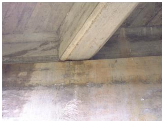
潜伏期、進展期の外観
