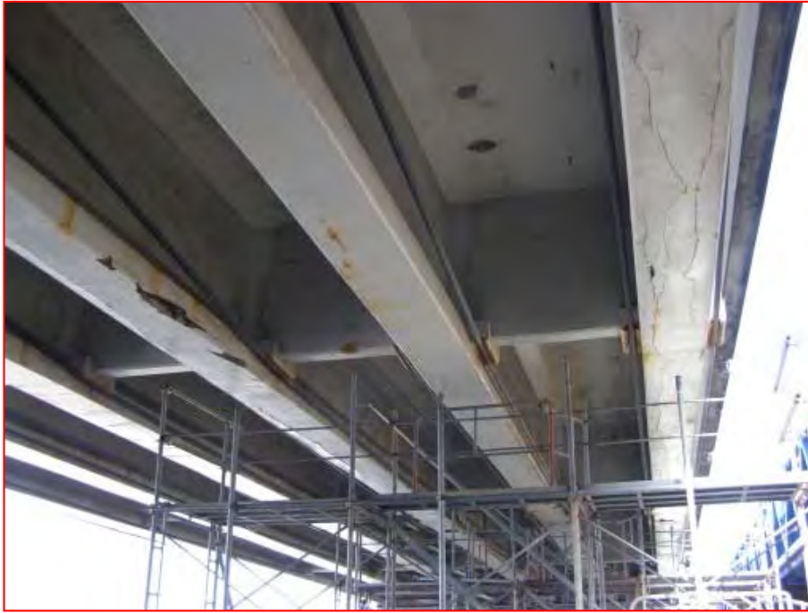
第2径間（劣化が大きい）
