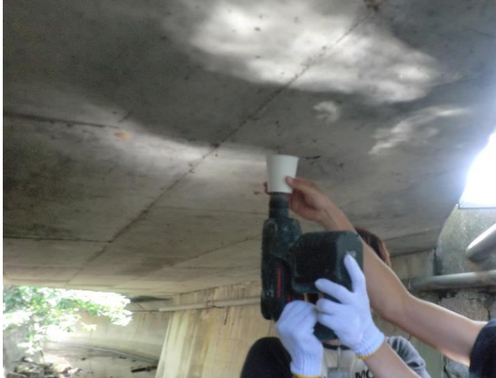
コンクリート粉末の採取状況
