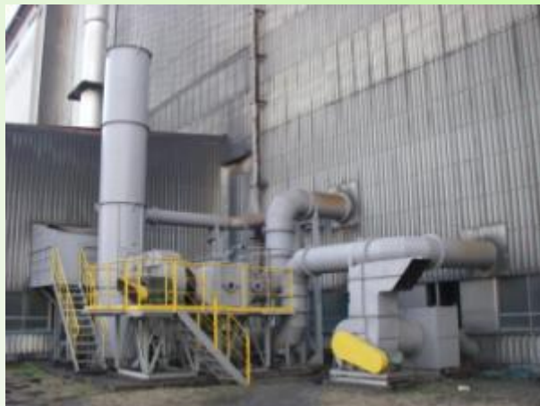
屋外排気設備 施工3年後
