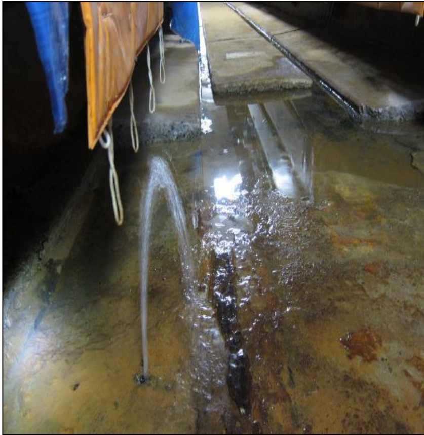
電力洞道漏水状況 都市NATM
