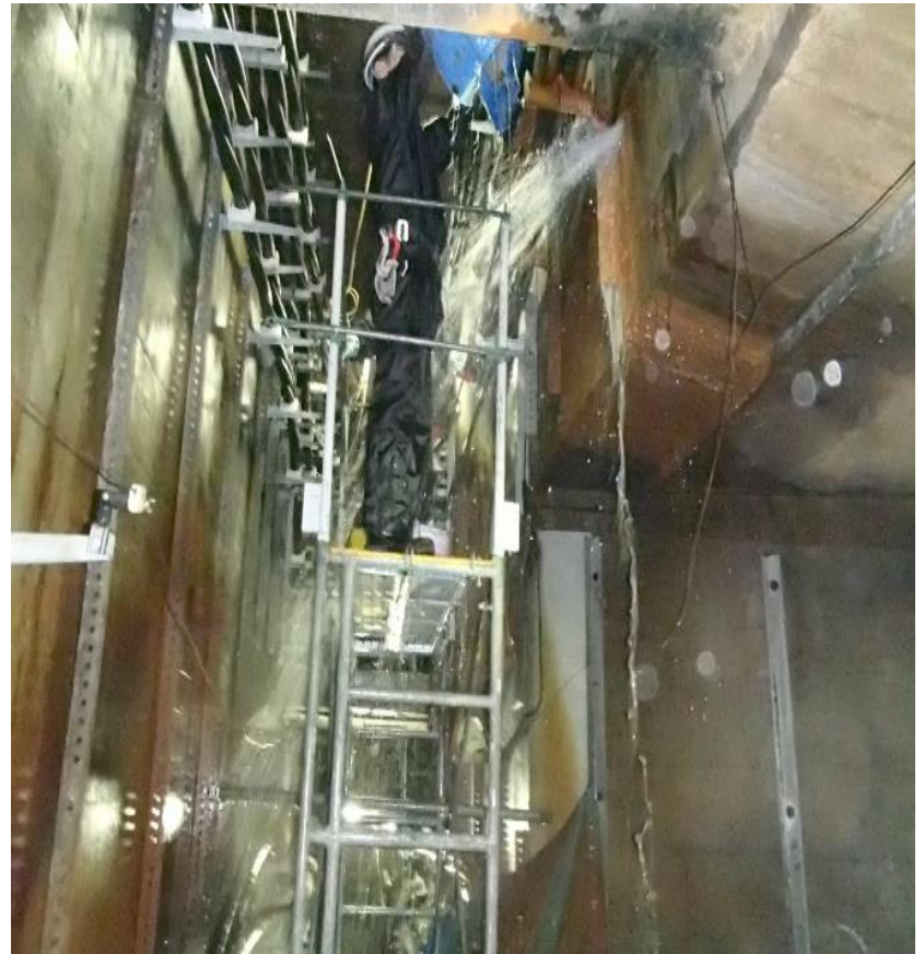
電力洞道漏水状況 多量漏水部（約200ℓ/min）
