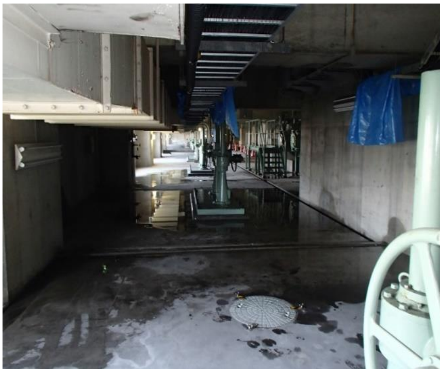
施工前：漏水状況 (平成29年11月時点)
