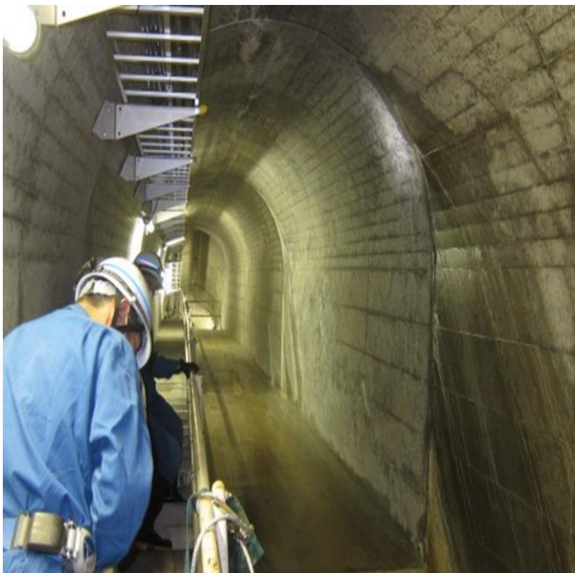
2013年4月(施工前) 漏水量 12リッター/分
