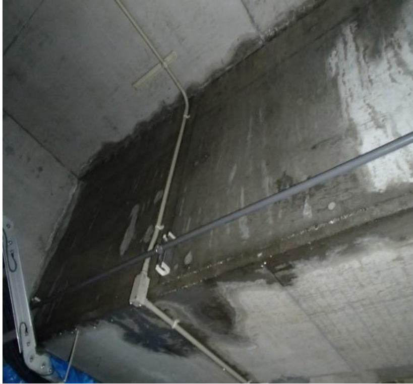
施工前：漏水状況 (平成29年11月時点)
