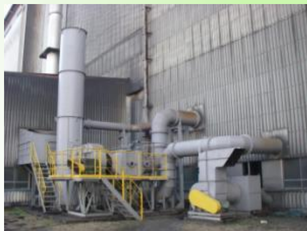
屋外排気設備 施工3年後
