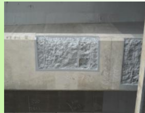
補修箇所拡大
