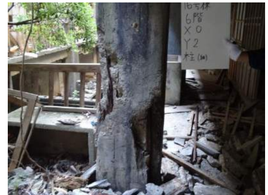
劣化度Ⅴ(柱)
