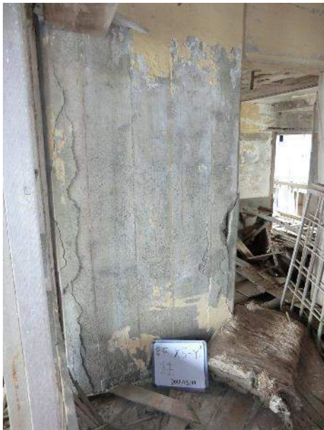
劣化度Ⅱ(柱)
