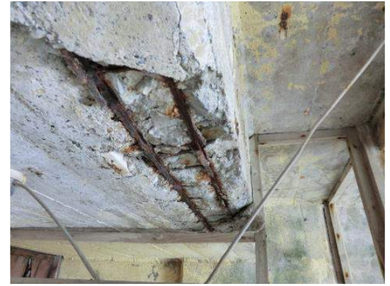
劣化度Ⅳ(梁)
