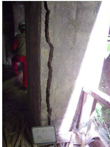
劣化度Ⅲ(柱)
