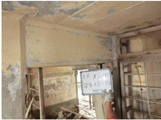
劣化度Ⅰ(梁)
