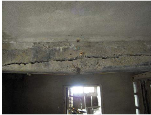
劣化度Ⅲ(梁)
