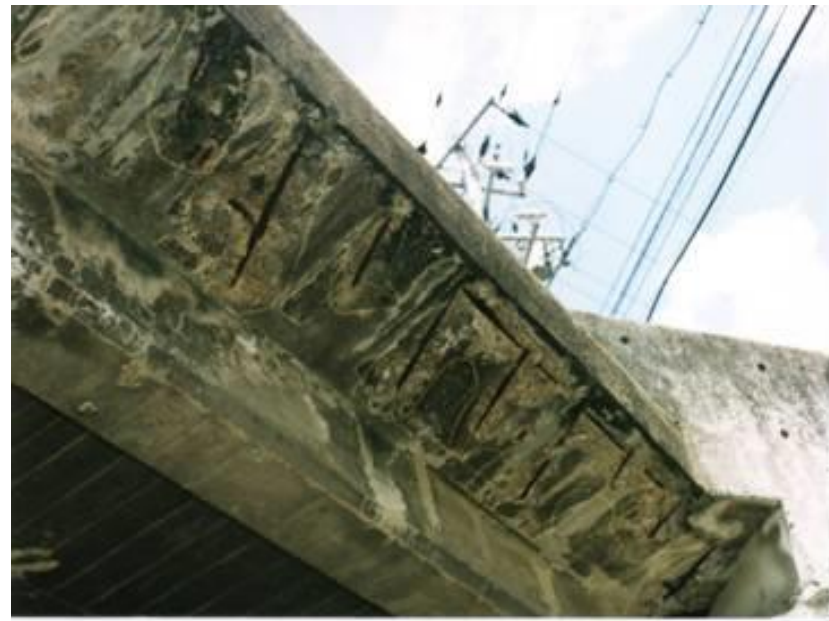
張出し床版下面の鉄筋露出
