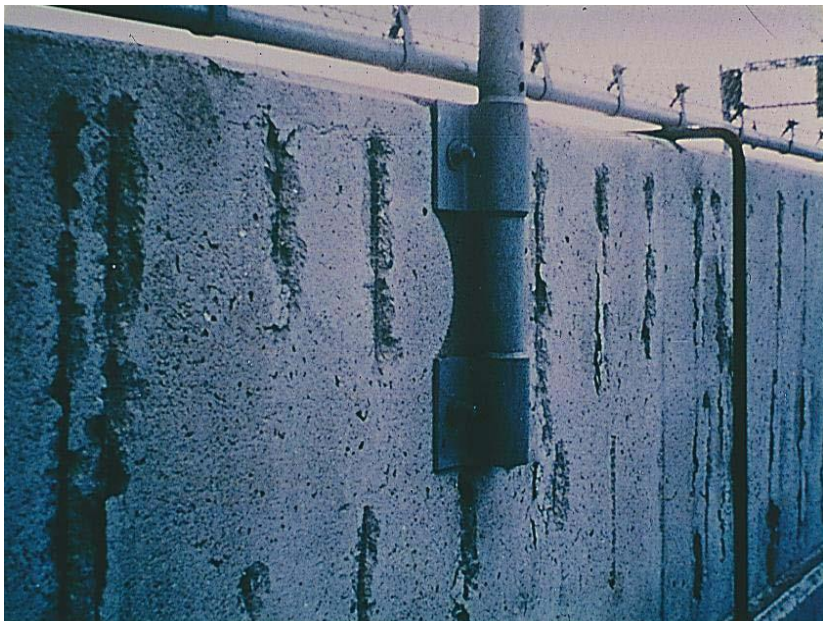
壁高欄のコンクリートはく落
