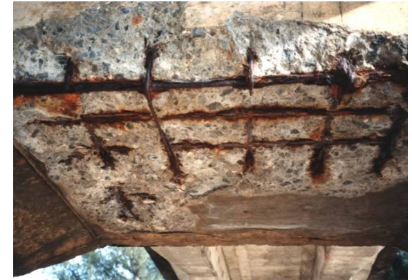
塩害による劣化
