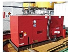
非常用発電機
