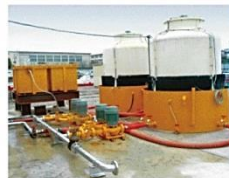
冷却設備 (クーリングタワー)
