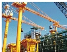
スケータークレーン
