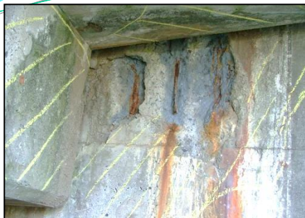
パラペットの損傷 付属物 0%
