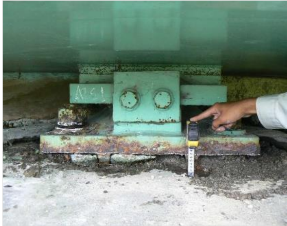
支承と沓座の劣化
