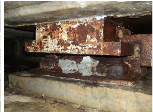
支承部の腐食
