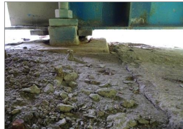
橋脚天端面の劣化損傷
