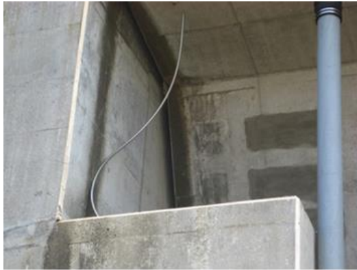
主桁やパラペットの汚れ
