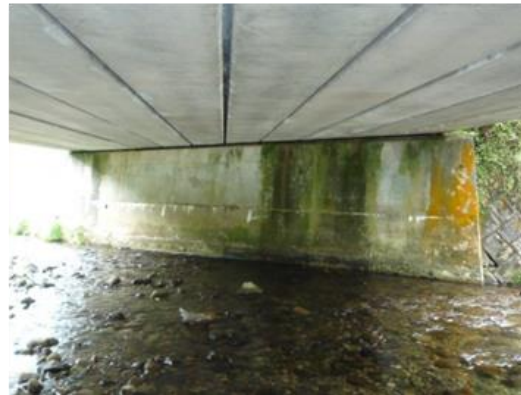
橋台前面の汚れ
