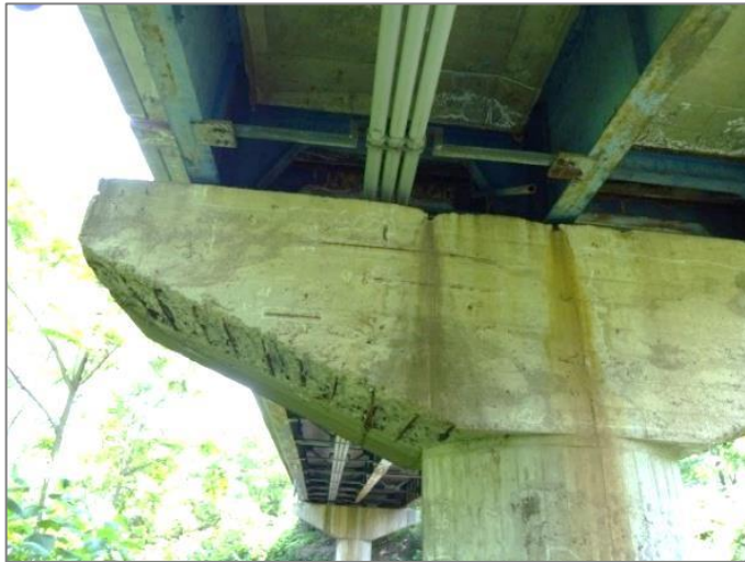
被りコンクリートの剥落
