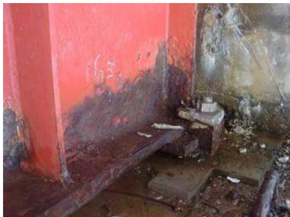
桁端部の腐食
