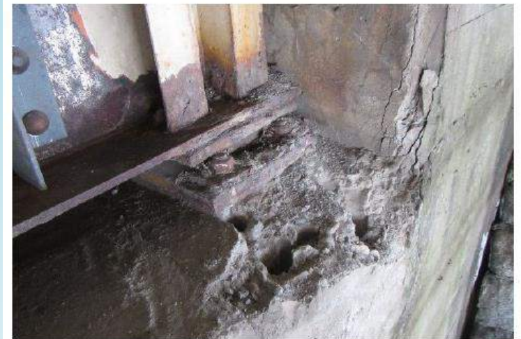
沓座コンクリートの剥離状況
