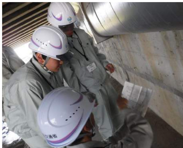
▲点検調書による損傷状況確認
