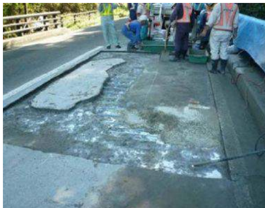
床版上面の劣化(切削後)
