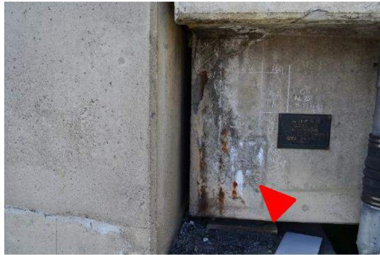
桁端部の漏水、剥離・鉄筋露出
