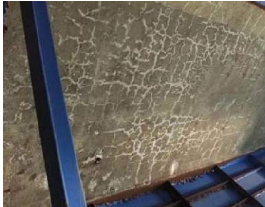
床版下面のひび割れ・漏水 ・遊離石灰
