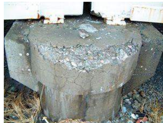
下部工沓座の欠損
