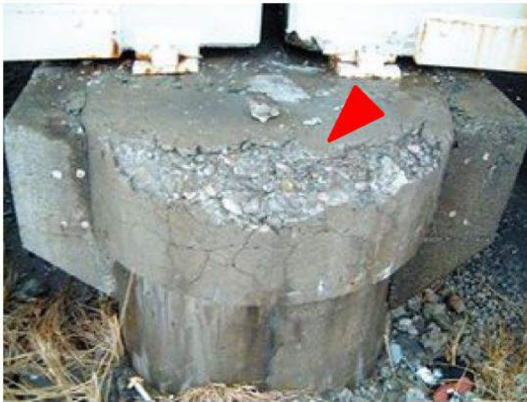
桁端部沓座の欠損
