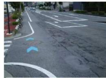
占用工事が起因する路面損傷
