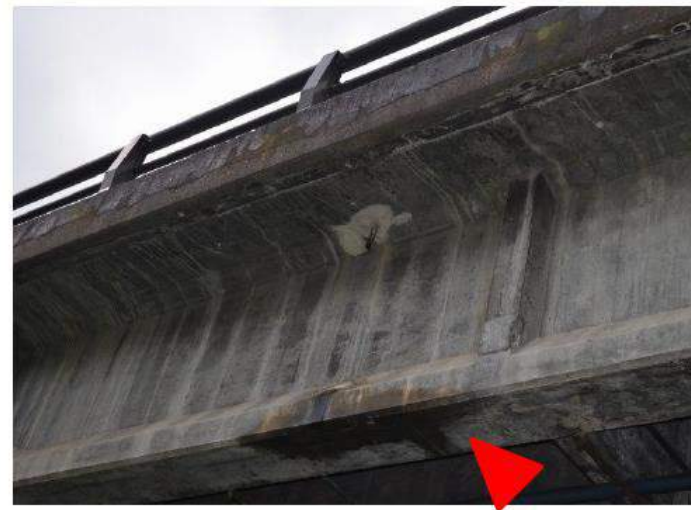
側桁の漏水・遊離石灰
