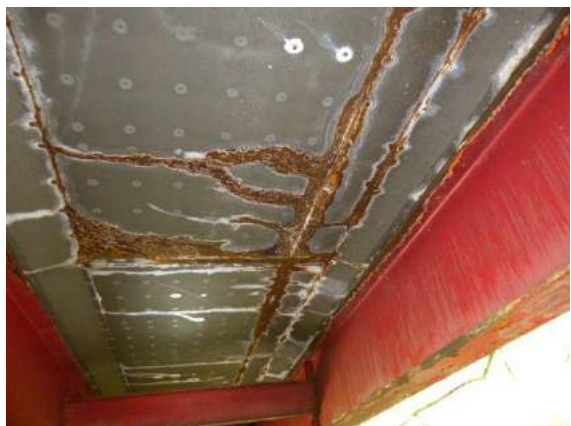
グレーチング床版 鋼板継ぎ目部の腐食
