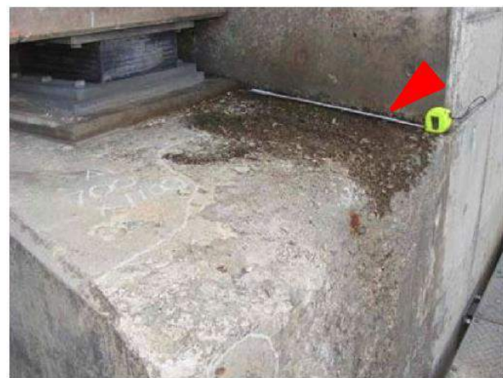
桁端部沓座の欠損
