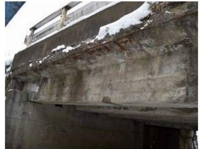
桁側面の水掛かりの劣化状況
