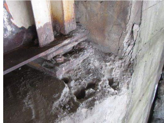
橋台沓座部の欠損
