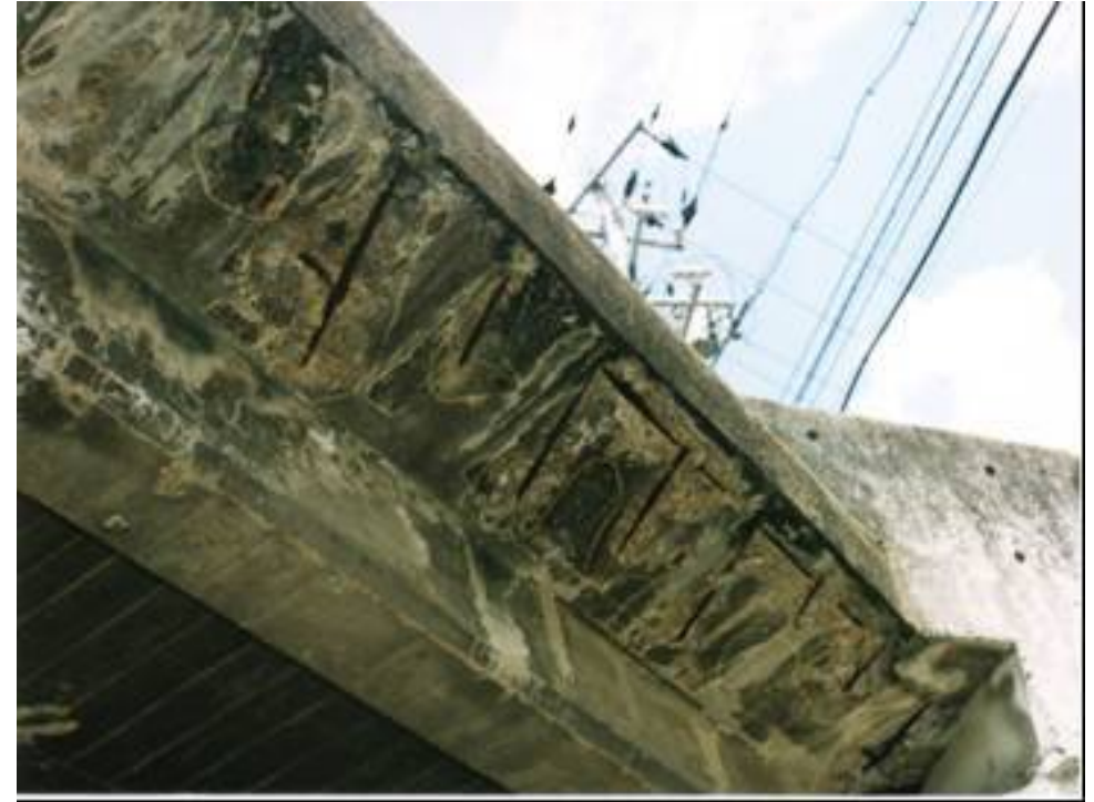
張出し床版下面の鉄筋露出
