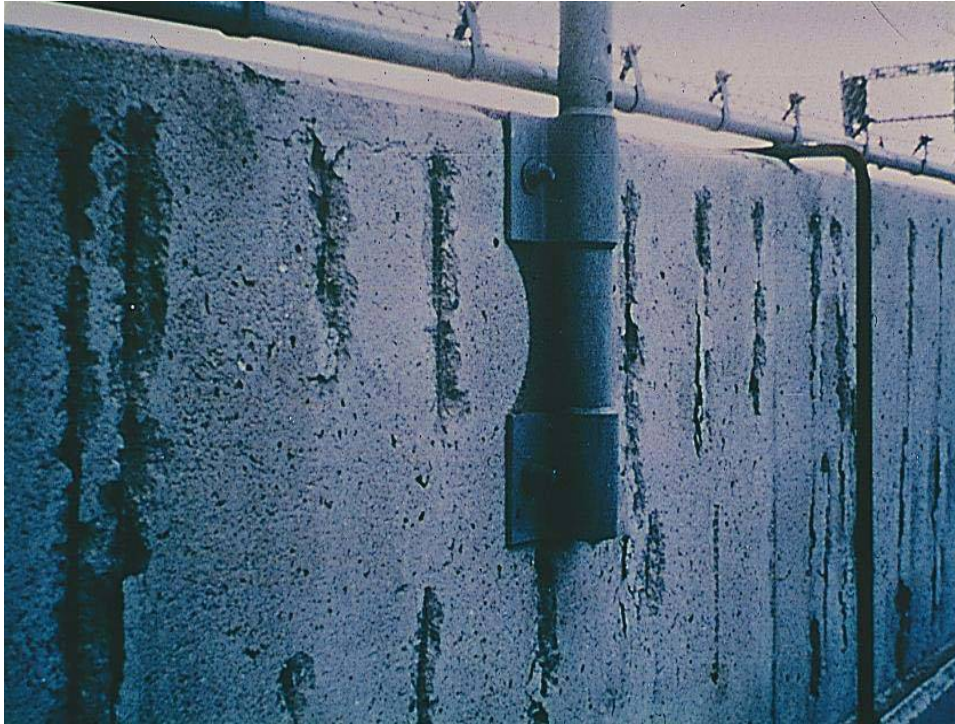
壁高欄のコンクリートはく落
