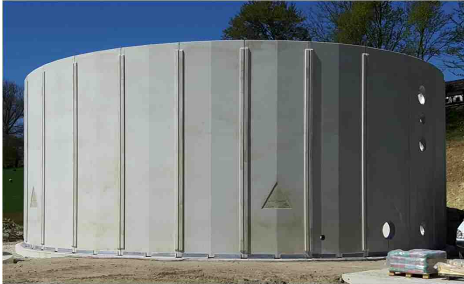
Pca製貯水タンク
