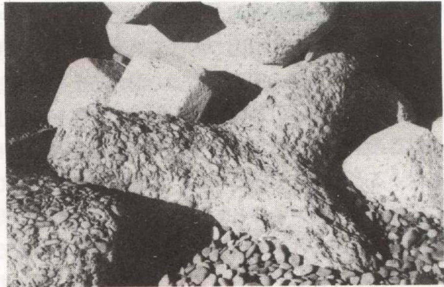
写真3. テトラポットのスケーリングによる劣化
