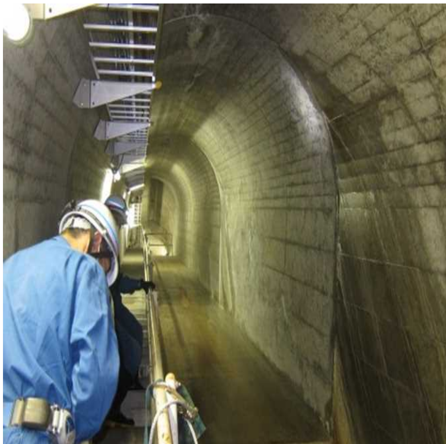
2013年4月(施工前) 漏水量 12リッター/分
