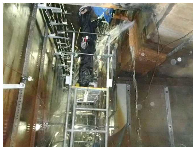
電力洞道漏水状況 多量漏水部（約200 ℓ / min）
