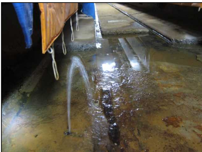
電力洞道漏水状況 都市N A T M
