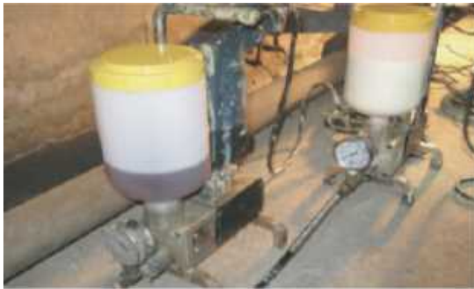
左側は硬化促進剤用ポンプ
