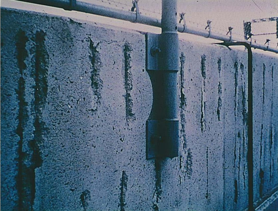
壁高欄のコンクリートはく落
