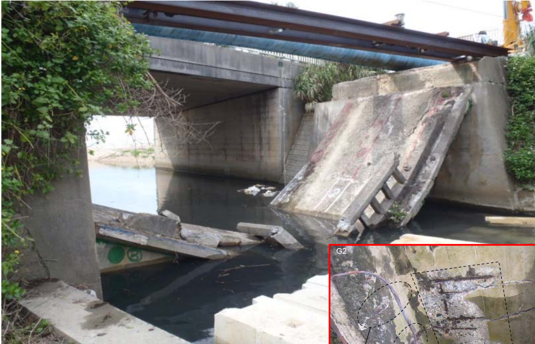
国道58号・大宜味村・旧津波橋 65歳(推定)、平成22年4月頃崩落
