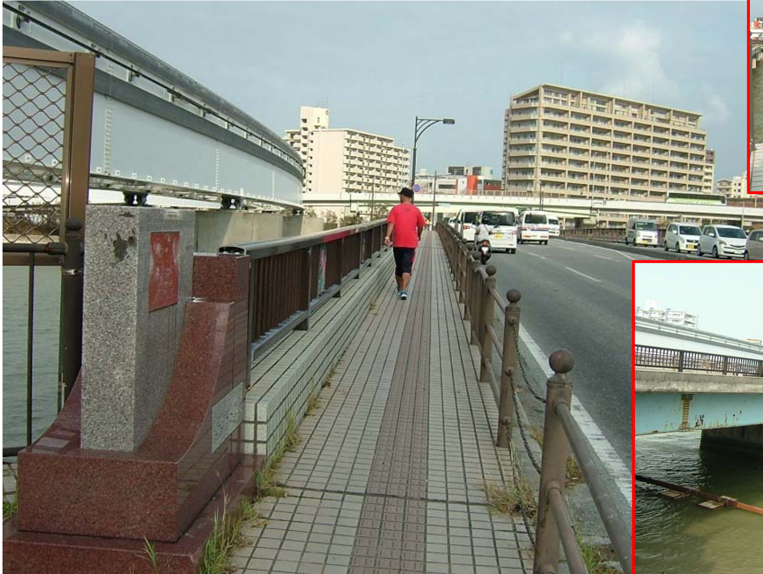
橋面写真・歩道が1m程度と狭い
