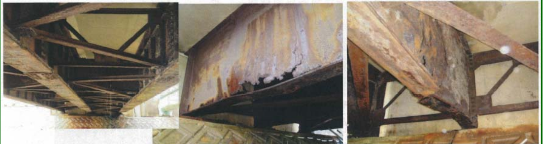
外桁の状況(フランジ・ウェブ間破断、座屈) 中桁の状況(下フランジ破断)
