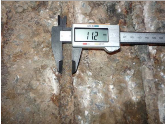
RC床版鉄筋腐食状況
