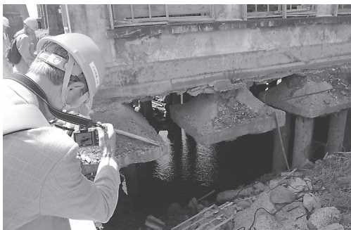
洗掘で杭がなくなった学校
