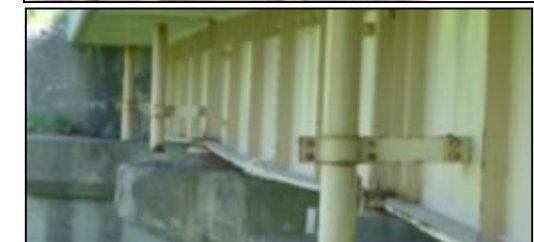
床版打替えの不備 → 桁の異常たわみ
