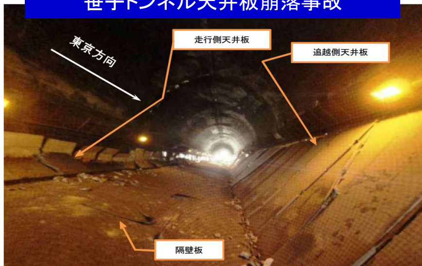
笹子トンネル天井板崩落事故
