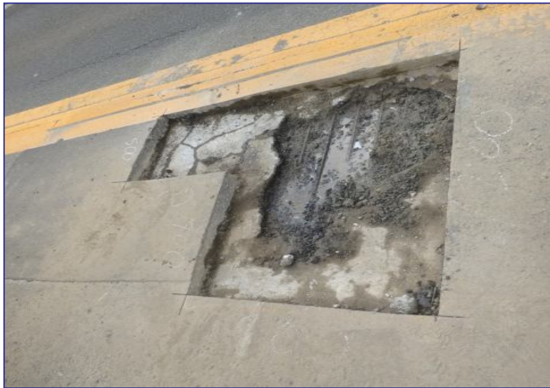
凍害による床版の剥離
