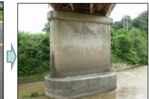
→ 原因は、 河床低下(河川改修) による基礎の傾斜
