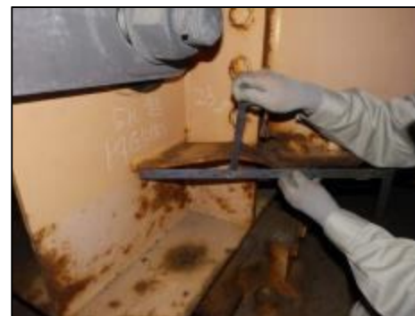
釧路沖地震 → 部材の変形
