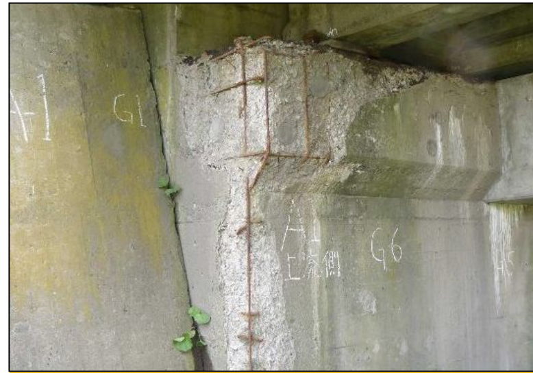
凍害による橋台の剥離
