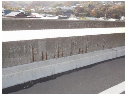
鉄筋露出(壁高欄)
