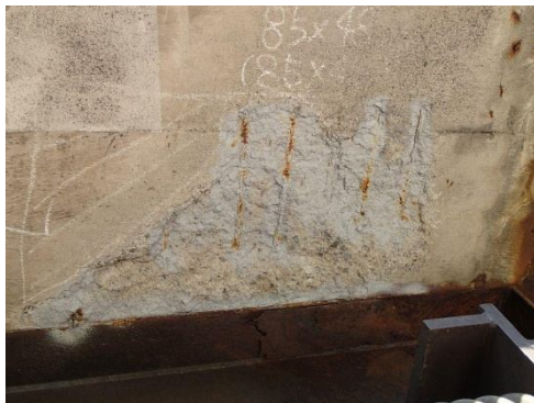
鉄筋露出(床版下面)
