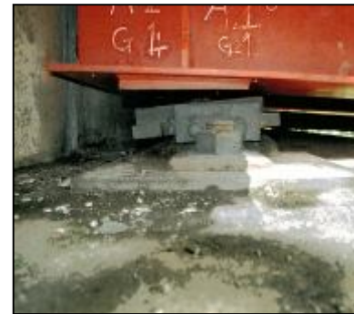
支承の遊間異常
