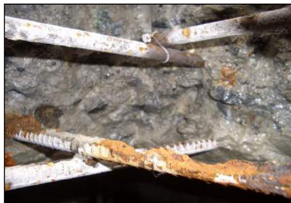
断面修復・表面被覆工法の再劣化
