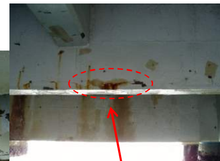
腐食ひび割れ
