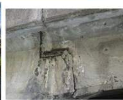
ゲルバー・ヒンジ部の損傷状況
