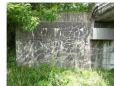
アルカリ骨材反応 ※ による橋台コンクリートのひび割れ
