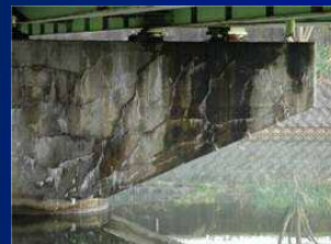
橋脚のASR劣化
