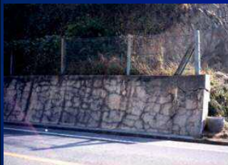
擁壁のASR劣化
