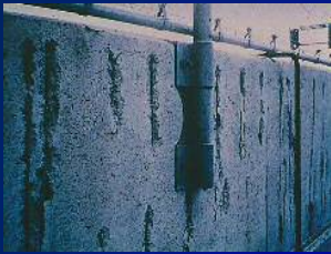
壁高欄のコンクリートはく落
