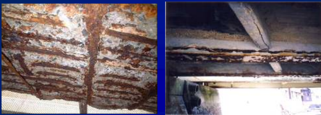
主桁下面の鉄筋腐食
