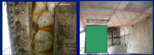
床版下面の錆汁
