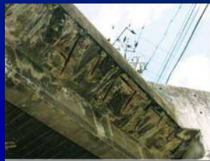
張出し床版下面の鉄筋露出
