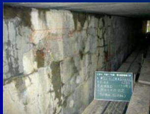
橋台のASR劣化
