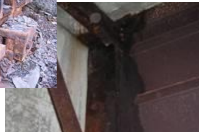
死角となっている箇所で損傷発見
