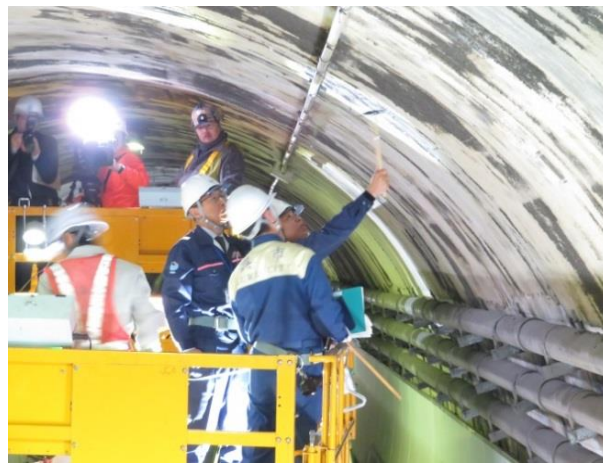
▲ 現地にて損傷状況を確認 (新原呉市長)
