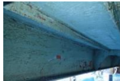
桁の塗装劣化やさびの発生
