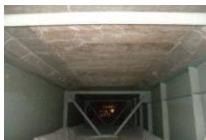
ひび割れの発生
