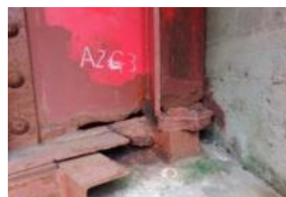
桁端部の腐食・貫通
