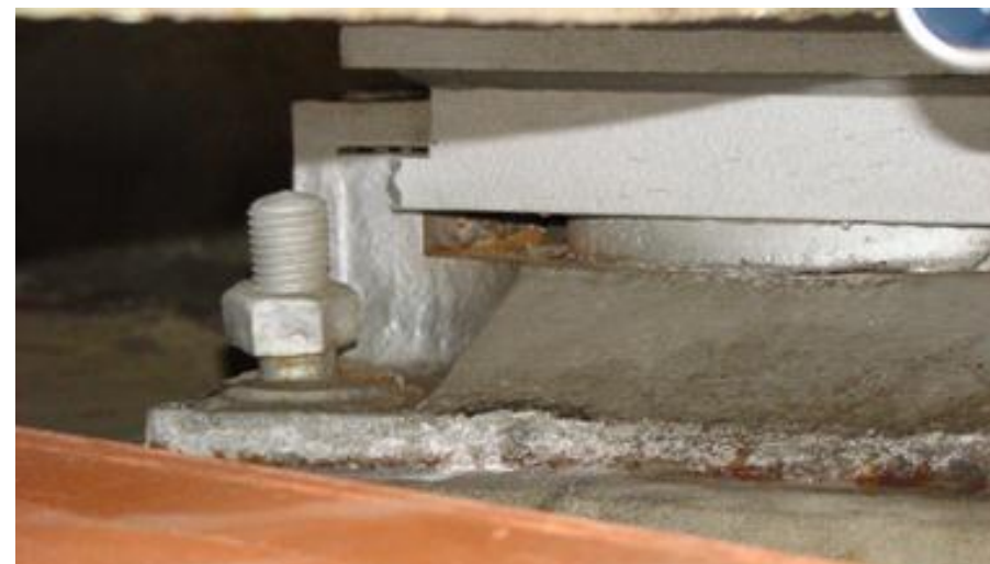
支承のアンカーボルトや取り付けボルトのゆるみ
