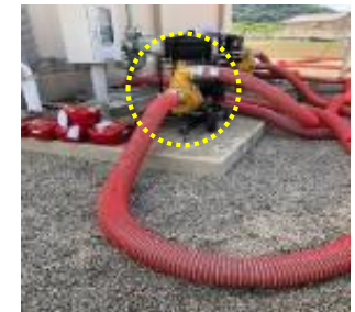
下水処理場等における 仮設揚水ポンプの確保（イメージ）
