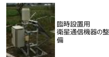
観測施設における 非常用電源等の確保
