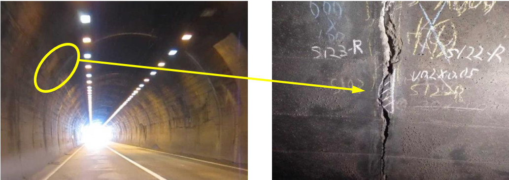
▲ 目地部のうき・はく離
