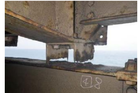
▲シェッド頂部の主梁端部 (破断の例)
