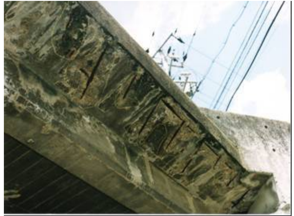
張出し床版下面の鉄筋露出
