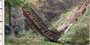
香川・徳島県境 無名橋(鋼2径間単純トラス橋) の落橋(2007年)
