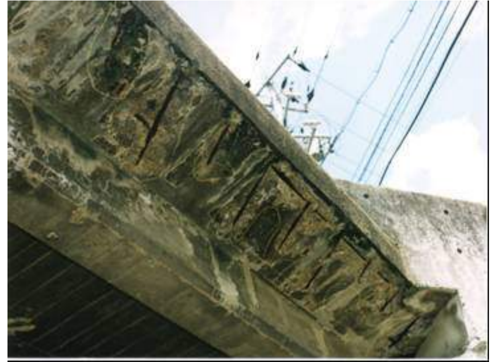
張出し床版下面の鉄筋露出
