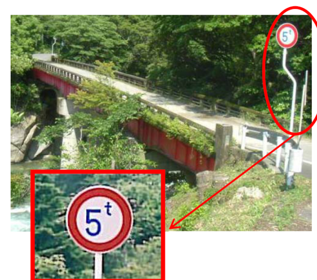
老朽化による通行規制の橋梁
