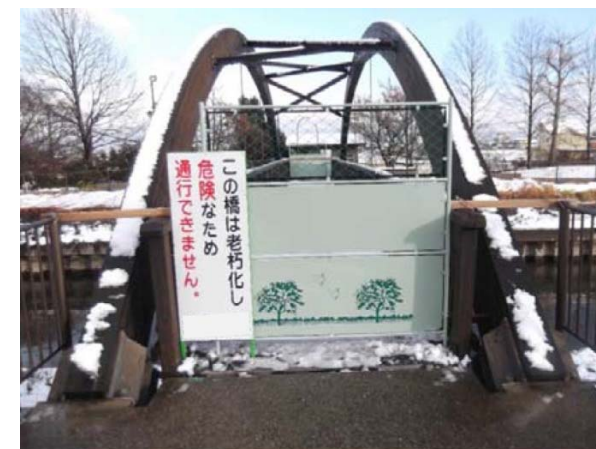
老朽化による通行止めの橋梁
