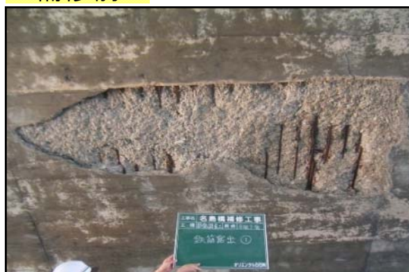
床板の剥離・鉄筋腐食
