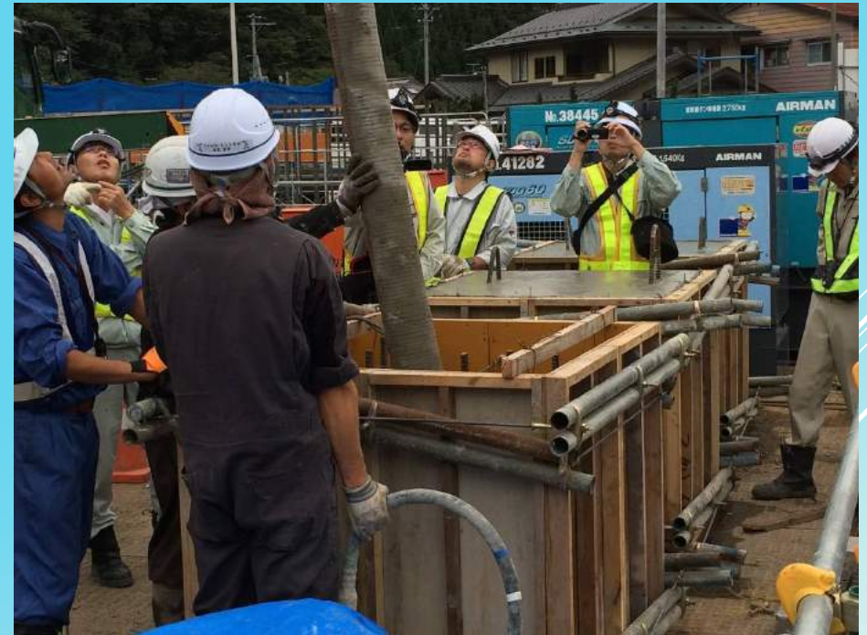
タイプ③不適切施工の吊し打ちの状況 ⇒ COを 自由落下
