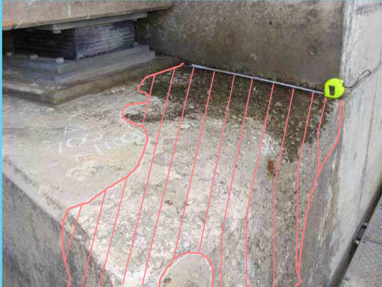
伸縮装置部から侵入した融雪水が繰り返し凍結融解したことによる損傷
