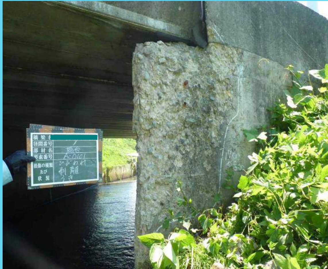
建設後 33 年経過した P C 床版橋の下部工表面の損傷状況
