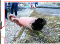
ターンバックルの破断
