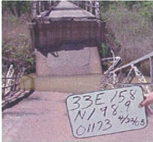
▲オクラホマ州無名橋重車両による落橋(2005)
