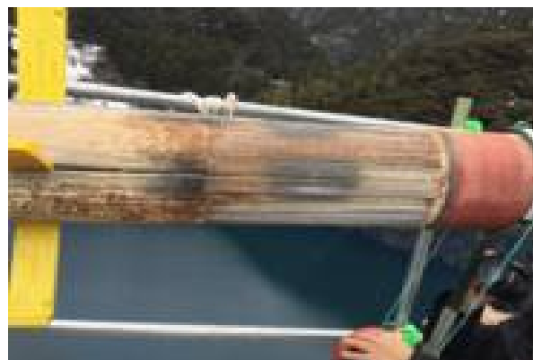
C17のケーブルバンド開放状況
