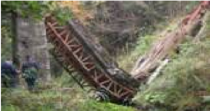
香川・徳島県境 無名橋 (鋼 2 径間単純トラス橋) の落橋 ( 2 0 0 7 年)
