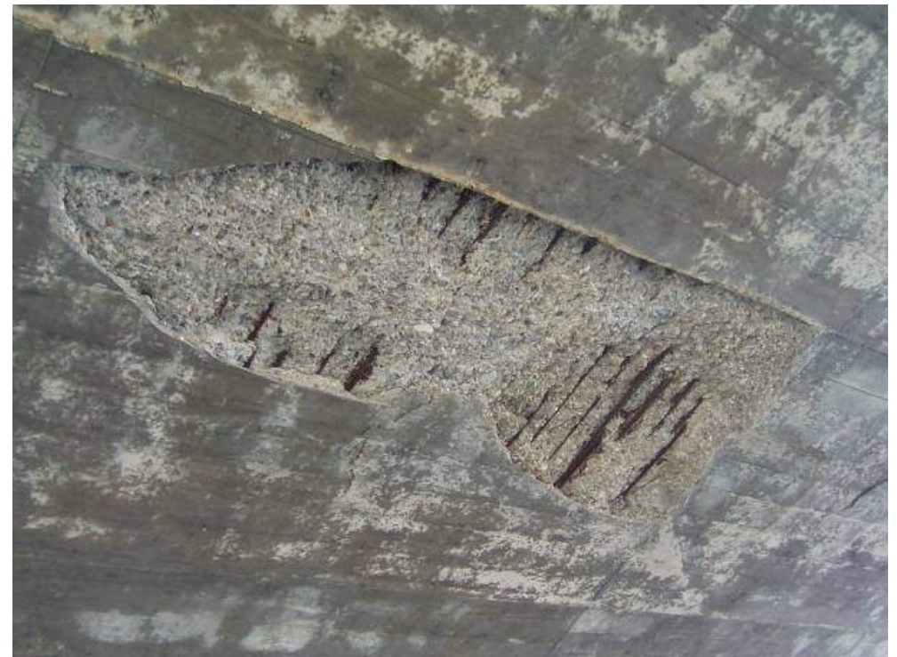
アーチリブ下面：剥離・鉄筋露出 (近景)
