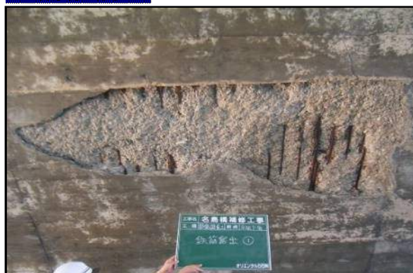
床板の剥離・鉄筋腐食
