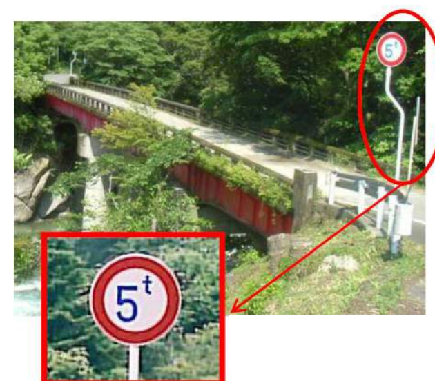
老朽化による通行規制の橋梁
