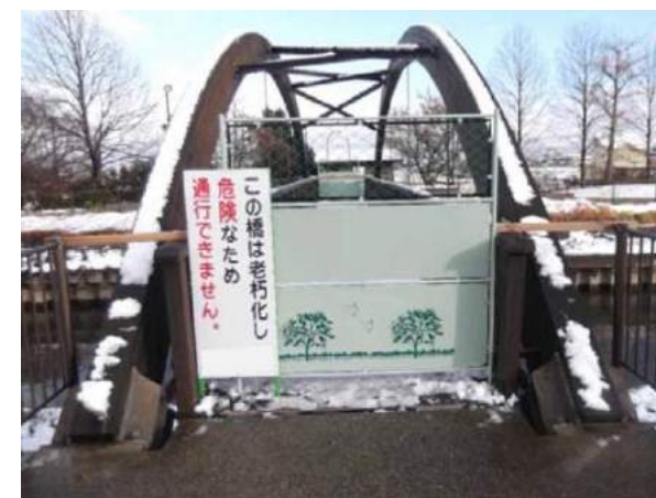
老朽化による通行止めの橋梁
