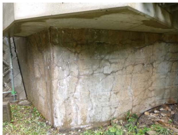
図-2 A1 橋台の外観変状
