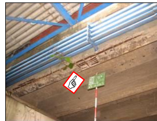
外桁部の剥離・鉄筋露出
