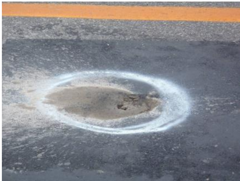
舗装面から土砂が噴出
