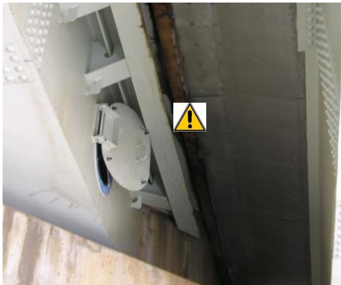
開かずの扉！ マンホール蓋と 縦桁が干渉、開かない...
