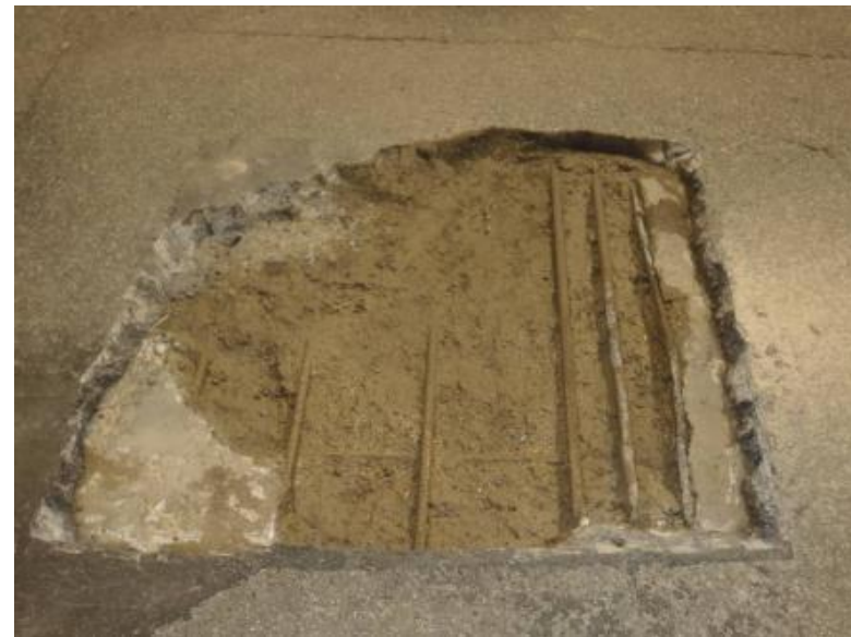
コンクリートの土砂化＋鋼材腐食
