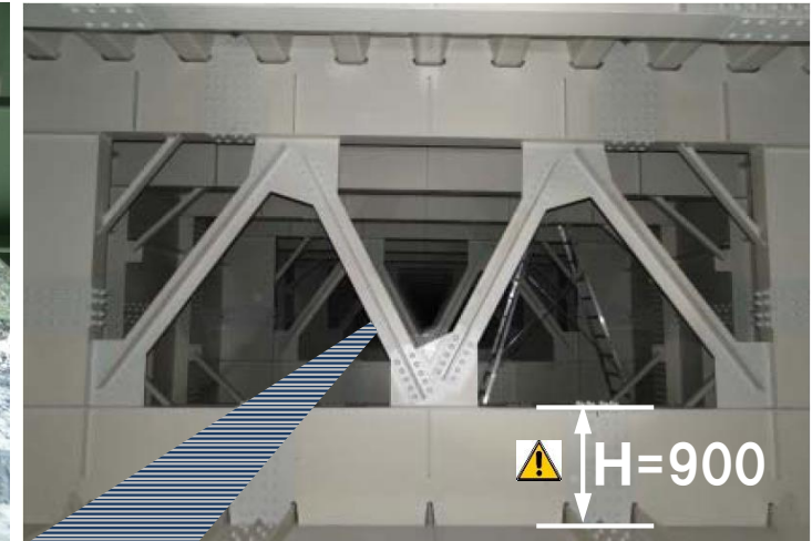
鋼箱桁中間ダイヤフラムが高い！ 検査路が必要だった...
