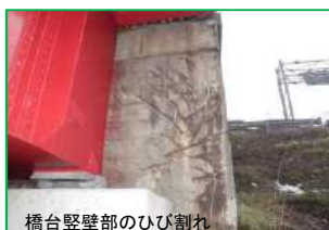
橋台縦壁部のひび割れ
