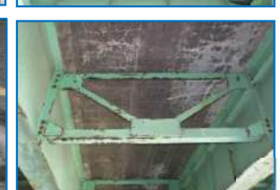
床版のひび割れ
