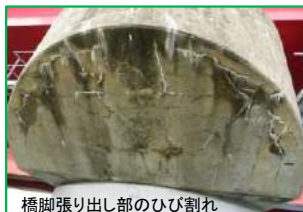
橋脚張り出し部のひび割れ
