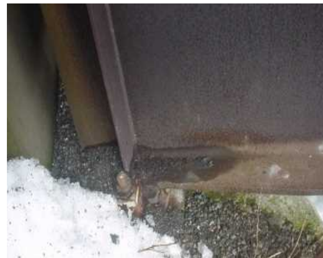
土砂堆積状況
