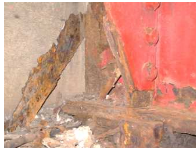
桁端部の著しい腐食
