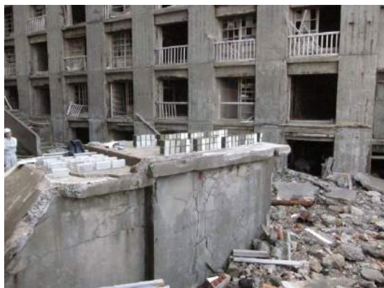
16号棟—59号棟間 (飛来塩分の多い環境)
