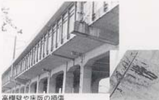
高層壁や床版の損傷
