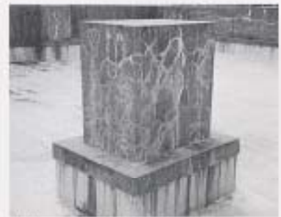
学校の屋上付近の損傷
