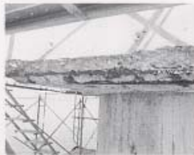
構造物の損傷
