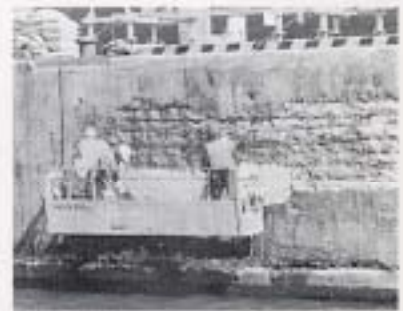
岸壁などの錆鉄筋（補修中）
